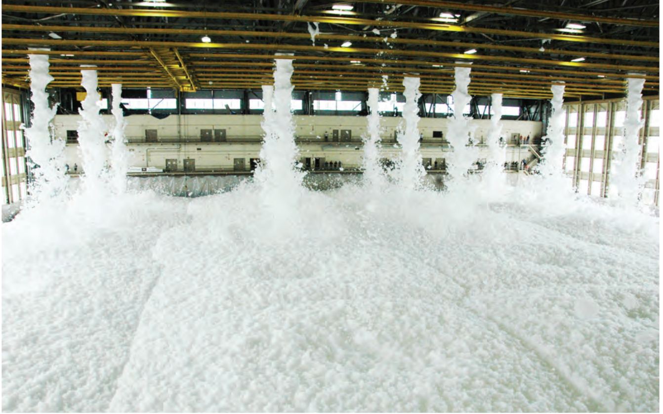
Uçak Hangarları Yüksek Genleşmeli Köpüklü Söndürme Sistemi
