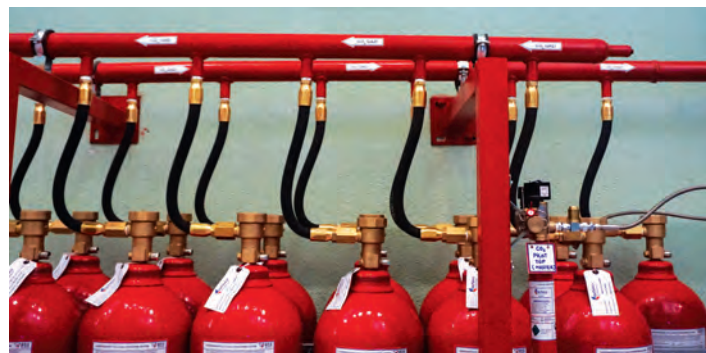
200 Bar Inert Sistemi Örneği
