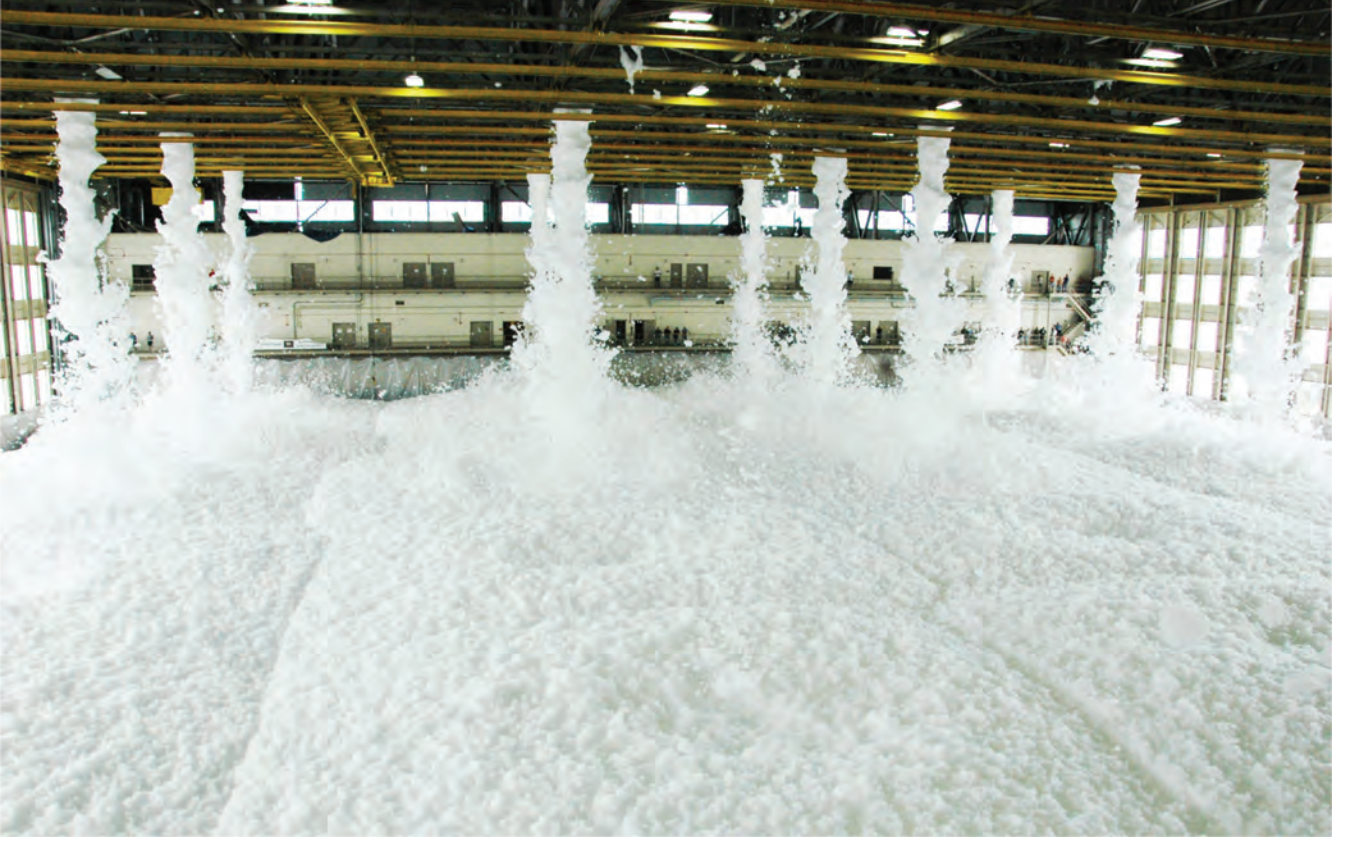
Uçak Hangarları Yüksek Genleşmeli Köpüklü Söndürme Sistemi
